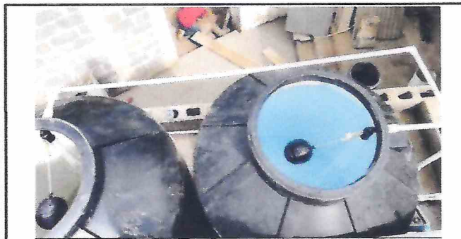
FOTO NO. 5 TINACO E INSTALACION DE AGUA
