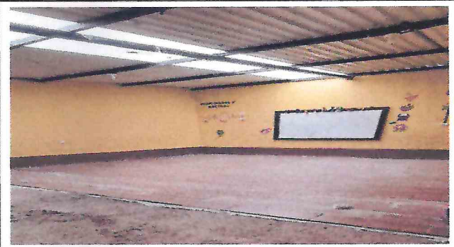
FOTO NO. 2 PISO DESNIVELADO Y DESCASCARADO POR MAS DE 20 CM
