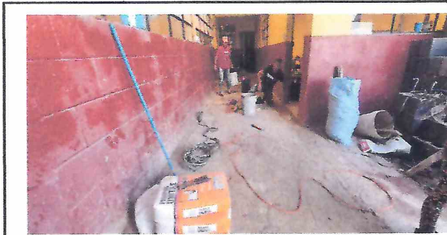
FOTO NO. 3 NIVELACION DE PISO DE PASILLO A NIVEL DE AULAS PARA QUE NO QUEDEN GRADAS
